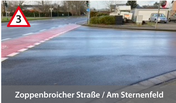
Achtung! An der Ampel fehlen Markierungen für den Fußgängerüberweg.
